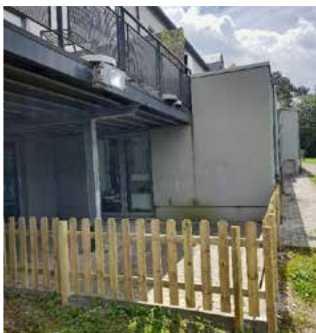
Sécurisation de la terrasse des locaux extrascolaires et intergénérationnels à la Pichelotte
