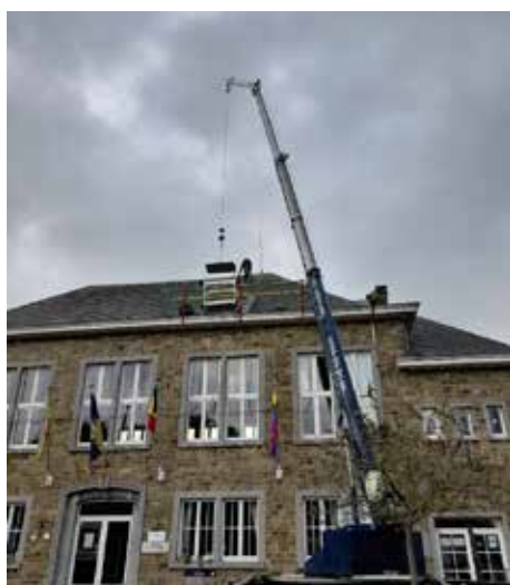
Démontage et remplacement du paratonnerre de la maison communale par l'entreprise FS toiture de Gesves
